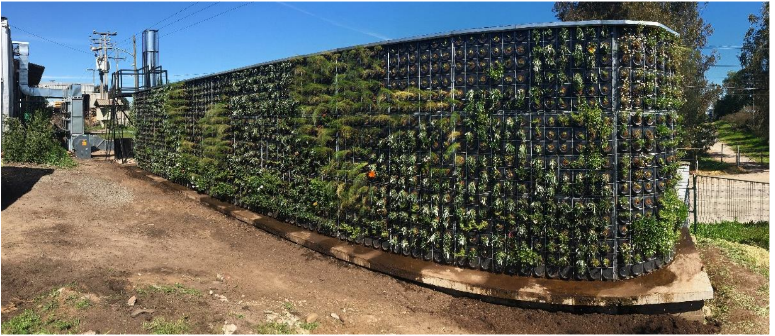
Sistema de filtración de material particulado diseñado para caldera de secado con biomasa, en Forestal Yukón
